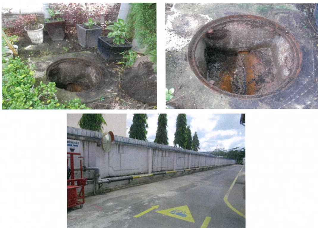
Hình 2.6. Một số hình ảnh hệ thống thoát nước thải của Nhà máy
