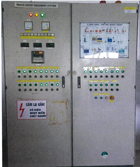
Hình 4.1. Tủ điều khiển trung tâm hệ thống xử lý nước thải
