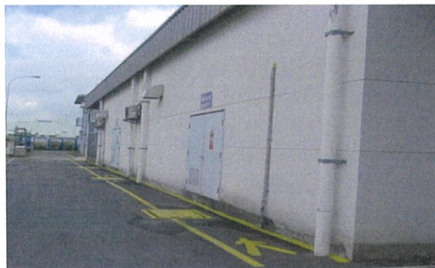
Hình 2.2. Một số hình ảnh hệ thống thoát nước mưa của Nhà máy
